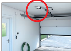
I taket intill motorskenan
